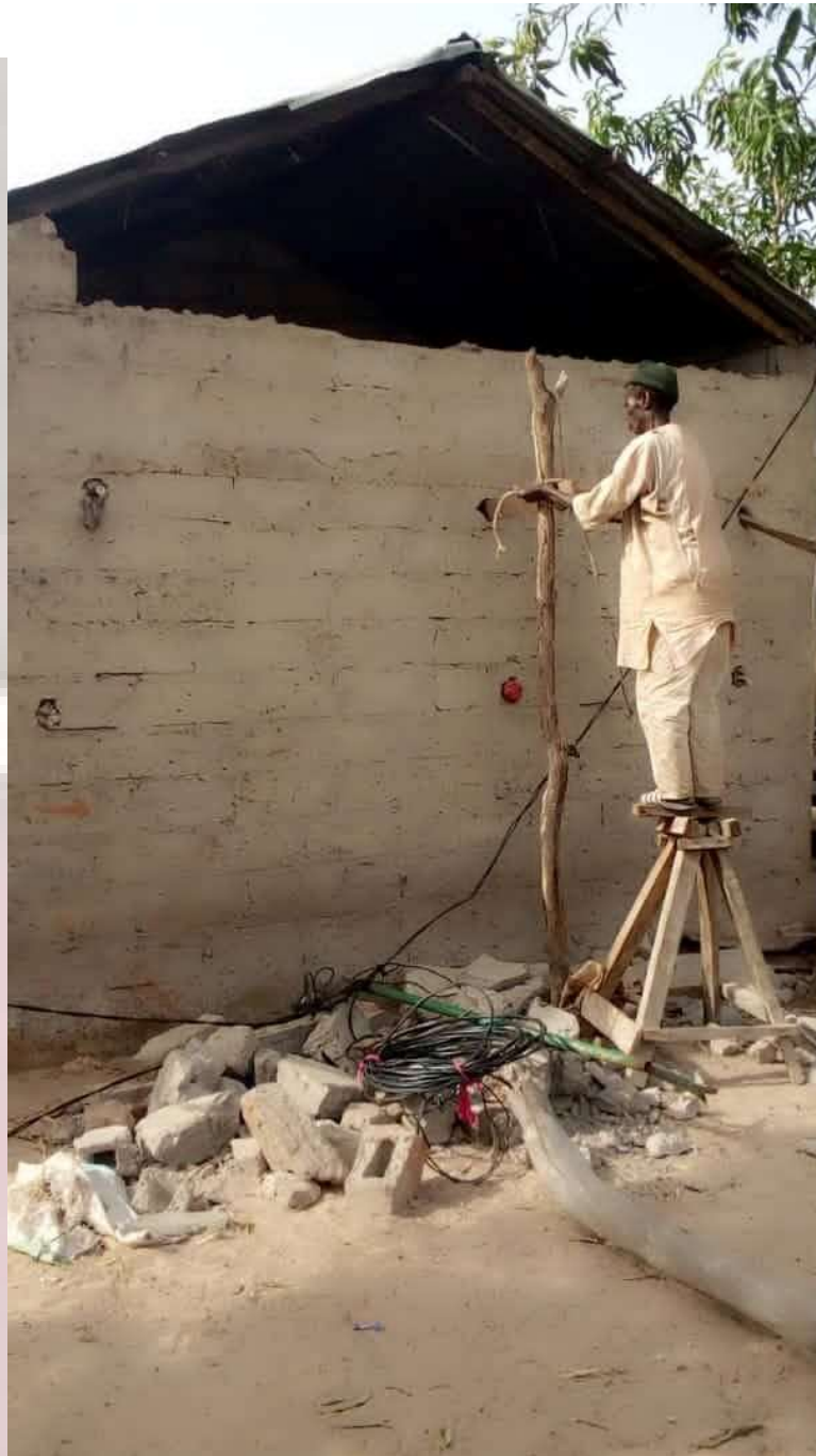
Foto: Vom Unwetter beschädigtes Haus einer Patenfamilie, das Dach ist angebracht, aber einige Reparaturarbeiten stehen noch aus.
